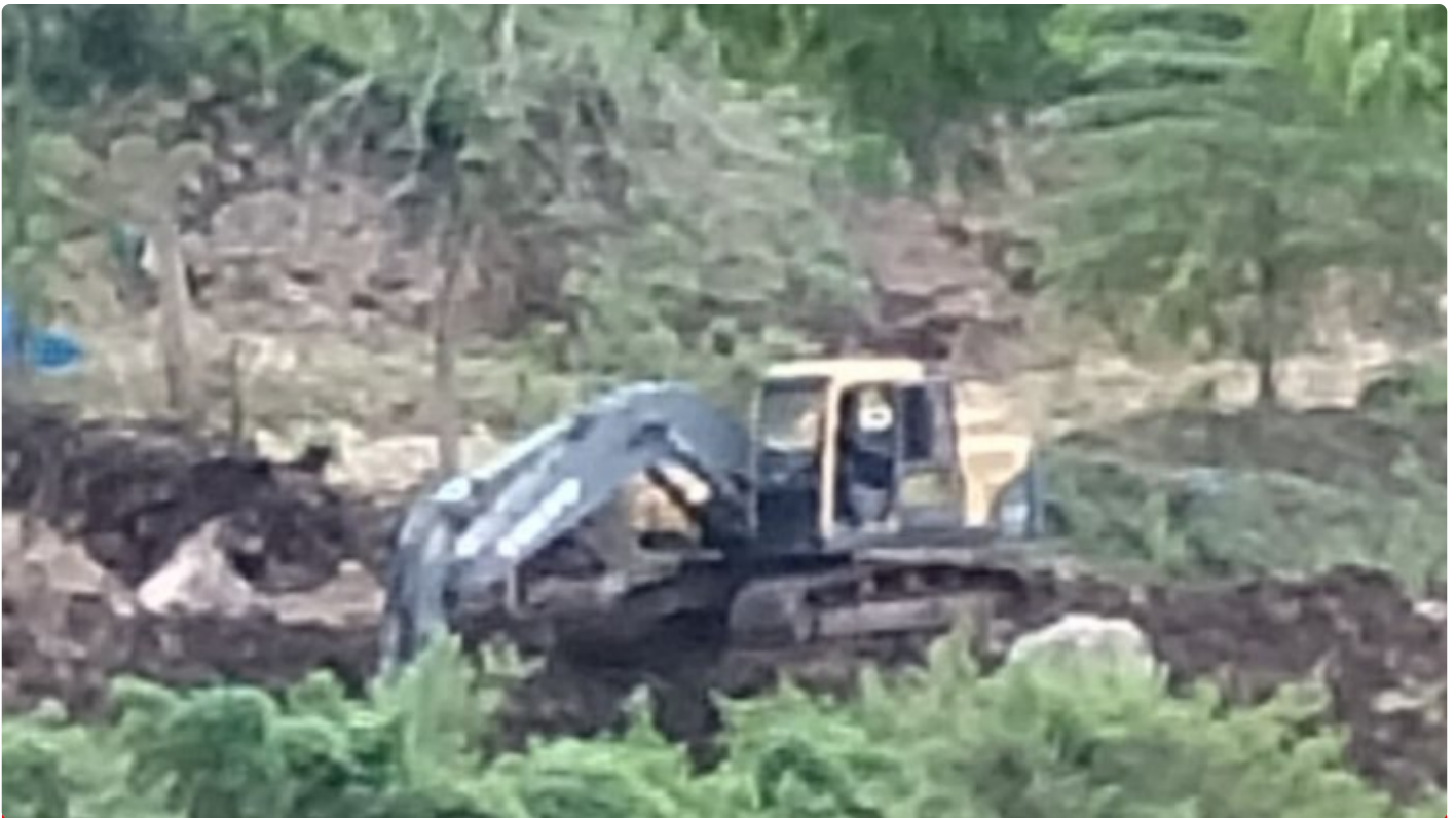
Satu Alat Berat Jenis Excavator Menambang Tanpa Izin di Desa Mattirowalie Tanete Riaja
